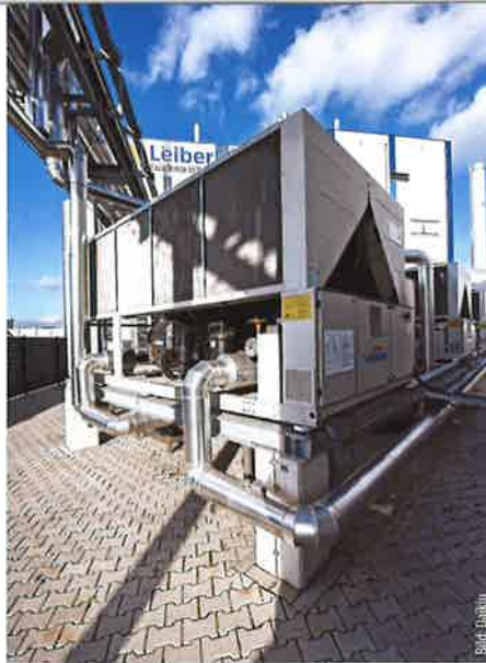
2 Die Kaltwassersätze sind in der Master-Slave-Regelung verbunden und bündeln ihre Leistung auf einem gemeinsamen Sammelrohr.
